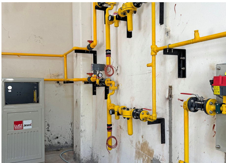
Chlorgasdosiergerät C2526(links) mit Gasrohrleitungssystem
