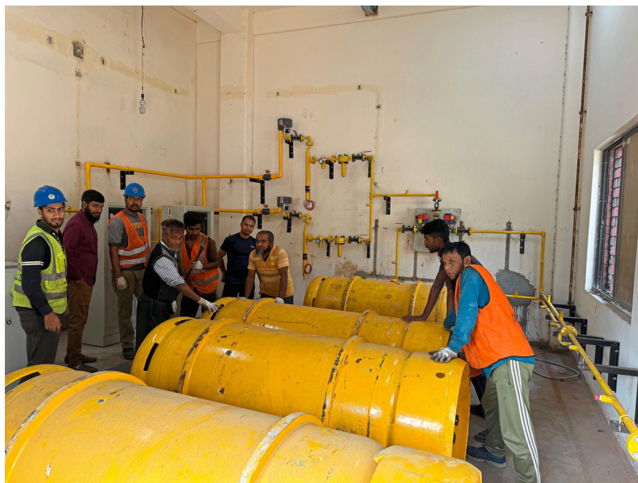
Das Chlorgas wird in gelben Fässern bereitgestellt.
